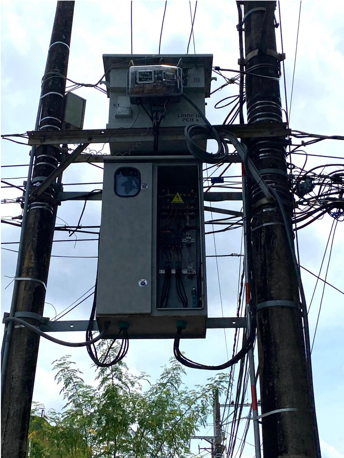
Caja de alimentación eléctrica sin una de sus puertas del gabinete.
