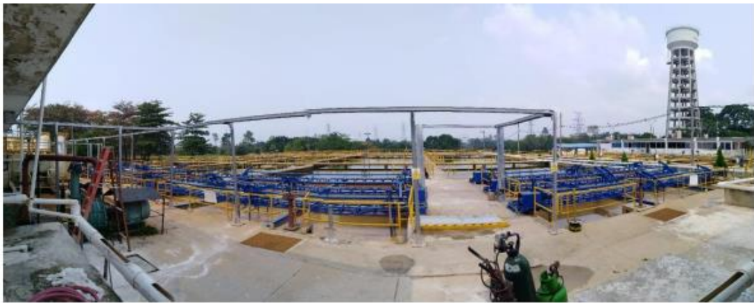
Imagen 1. Panorámica nuevo sistema de floculación tipo balancín.
