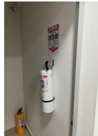
CÁMARA Y EXTINTORES
