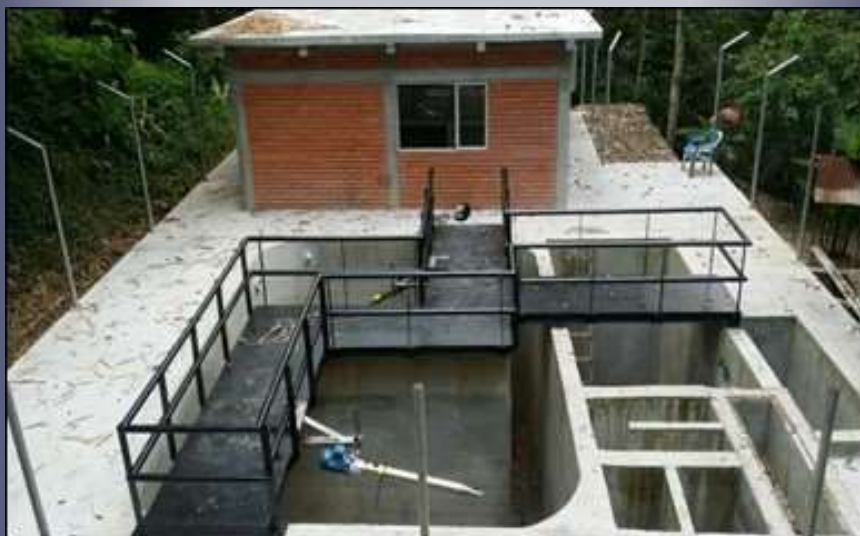
Foto PTAR. NUEVO HORIZONTE
