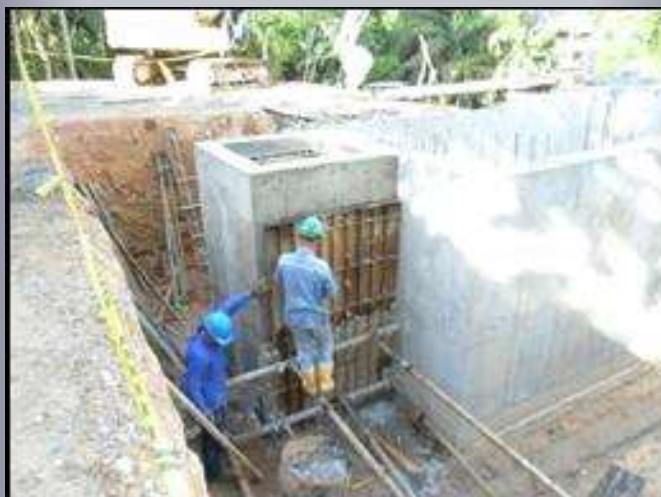
Foto PTAR. NARANJOS
