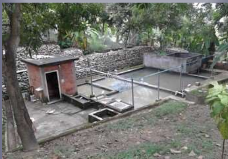
Foto PTAR. ALTOS DEL CINCUENTENARIO
