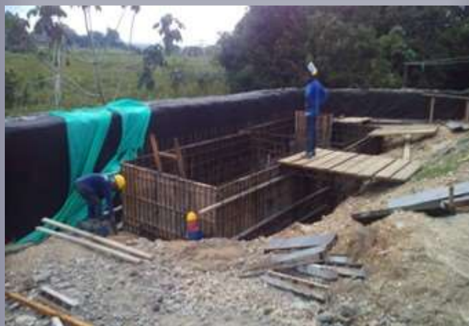
Foto PTAR. CINCUENTENARIO VII ETAPA
