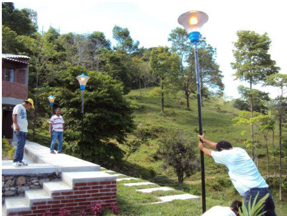
Foto No 35. Iluminación áreas externas
