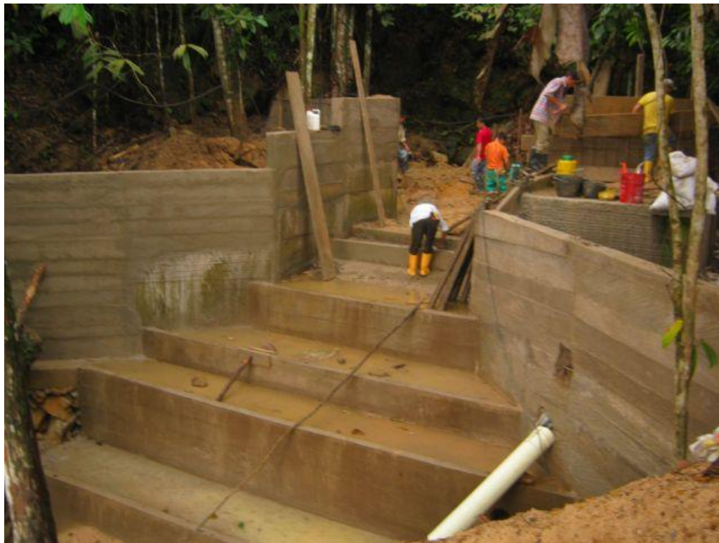
Foto No 17. Disipadores de energía para la bocatoma
