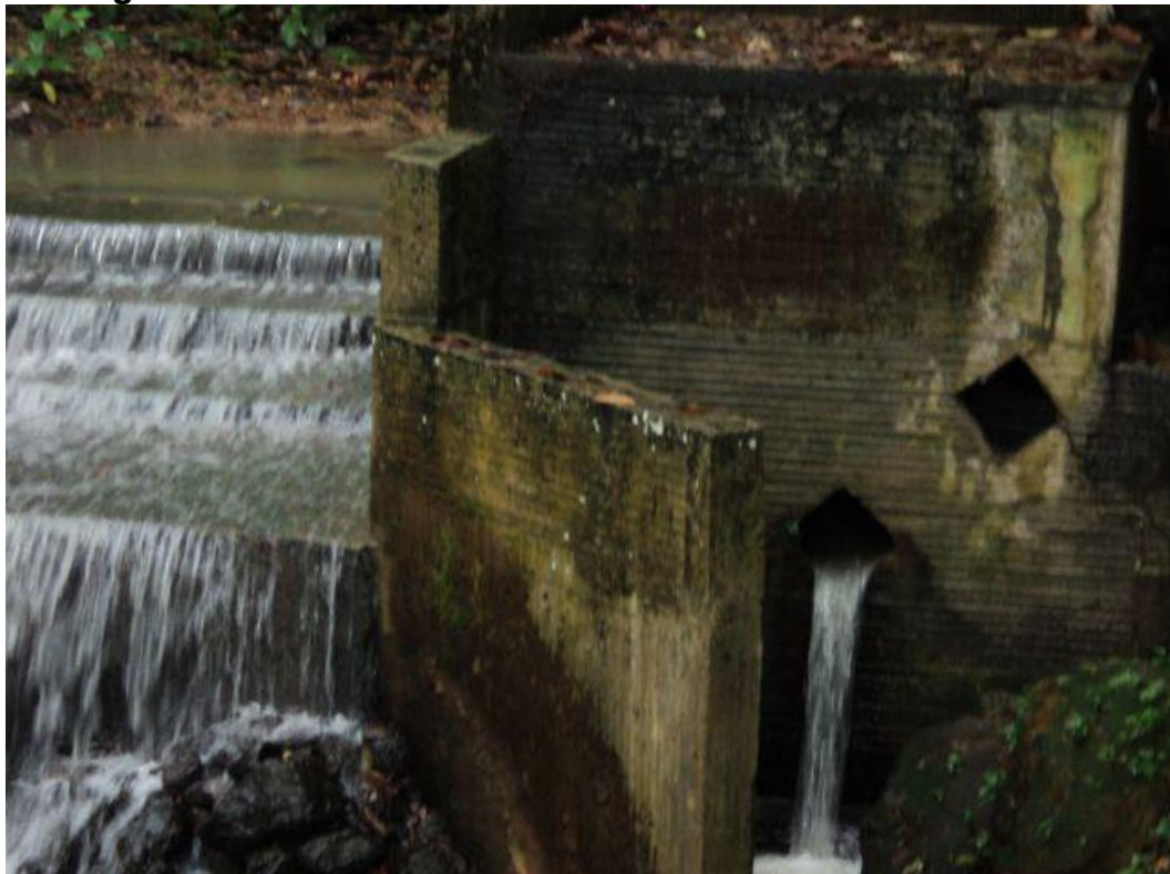
Foto No 12. Estado inicial de la Bocatoma del acueducto veredal del corregimiento de La Fortuna Barrancabermeja
