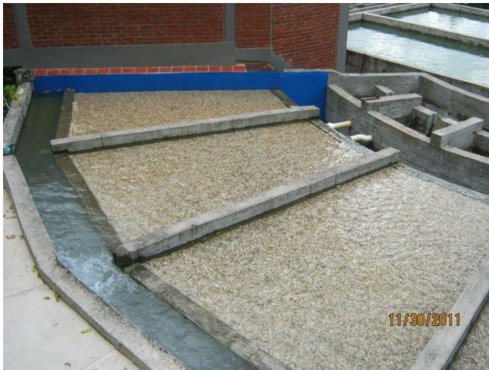
Foto No 29. Filtro Dinámico lecho filtrante
