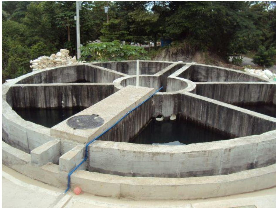
Foto No 33. Filtros Rápidos con lecho filtrante
