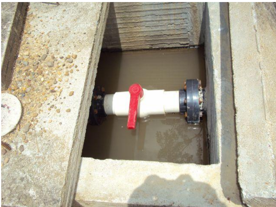
Foto No 21. Válvula PVC 4" de ingreso al Desarenador
