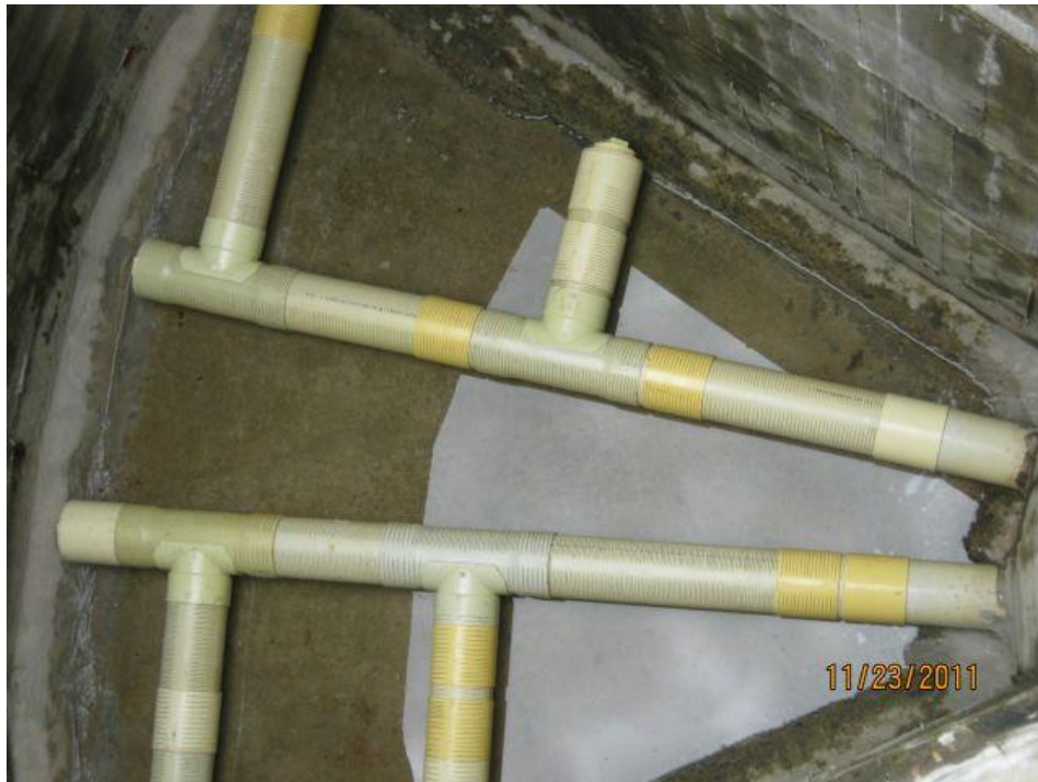
Foto No 32. Filtros Rápidos tubería perforada
