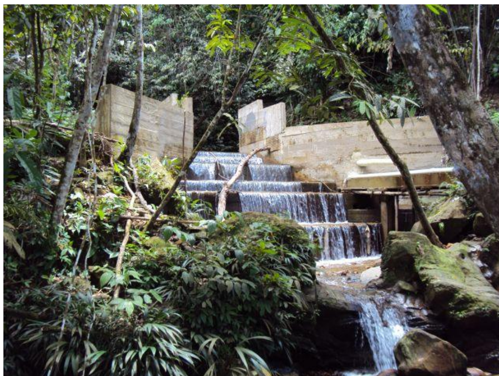
Foto No 18. Bocatoma finalizada en funcionamiento
