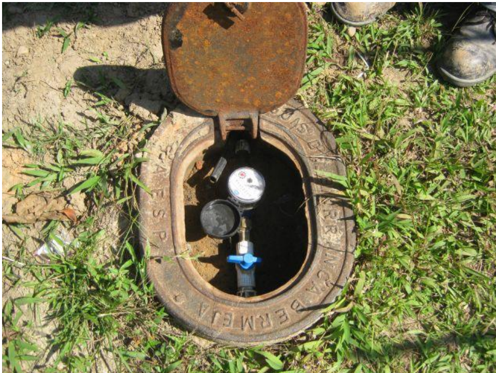
Foto No 45. Medidor y caja con tapa metálica.
