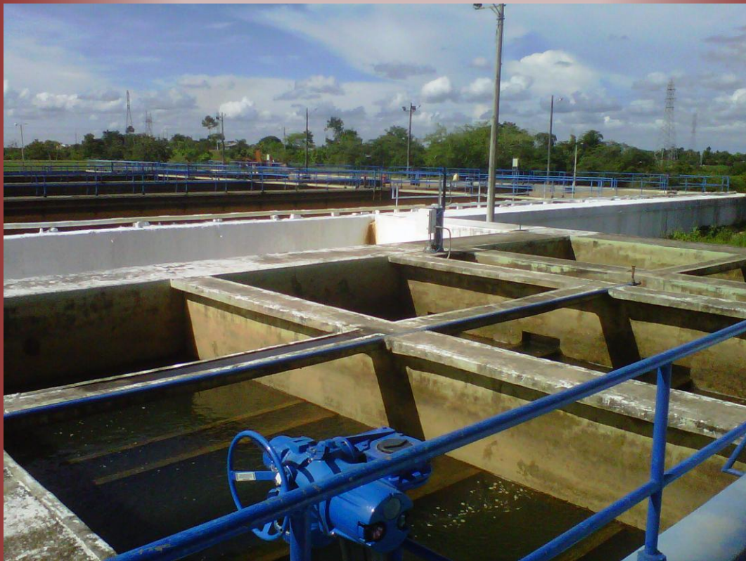
Foto No 3. Área de filtros Planta de Tratamiento de Agua Potable Municipio de Barrancabermeja
