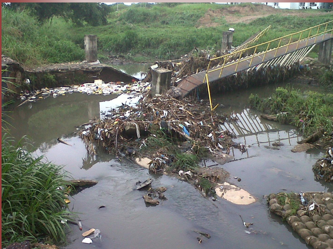
Foto No 1. Colapso Cribas de Residuos Sólidos Caño las Camelias Municipio de Barrancabermeja
