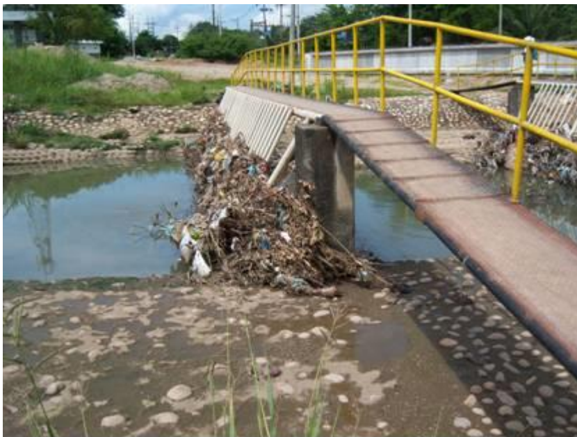
Foto No 16 Perdida de carga de 60 cm. Criba No 2 por represamiento de residuos sólidos
