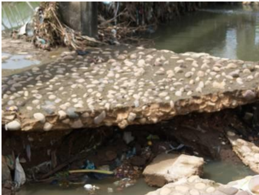
Foto No14 Estructura de estabilización del cauce del Caño Las Camelias, en el aire por desbordamiento del flujo ocasionado por el represamiento de residuos sólidos
