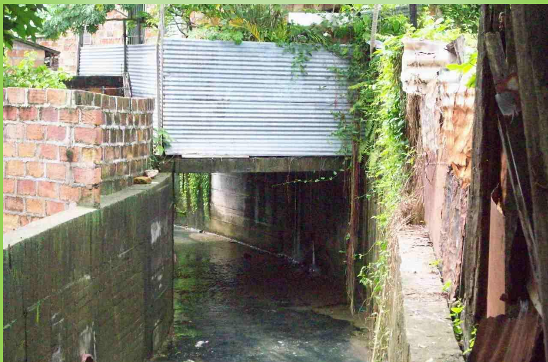
Foto No 6. Invasión de la Ronda Hidráulica, Ramal Primero de Mayo del Caño Las Camelias, Barrio Provienda en el Municipio de Barrancabermeja
