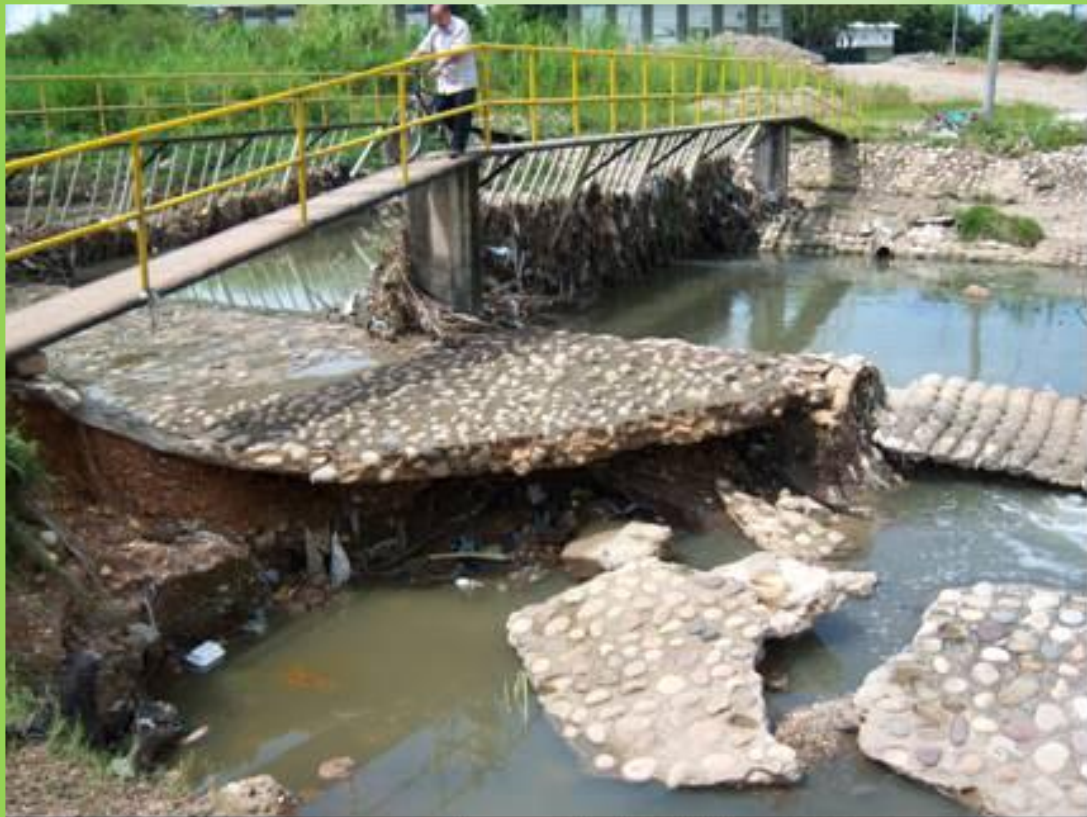
Foto No 8. Caída de las estructuras de protección del cauce del caño las Camelias en Barrancabermeja
