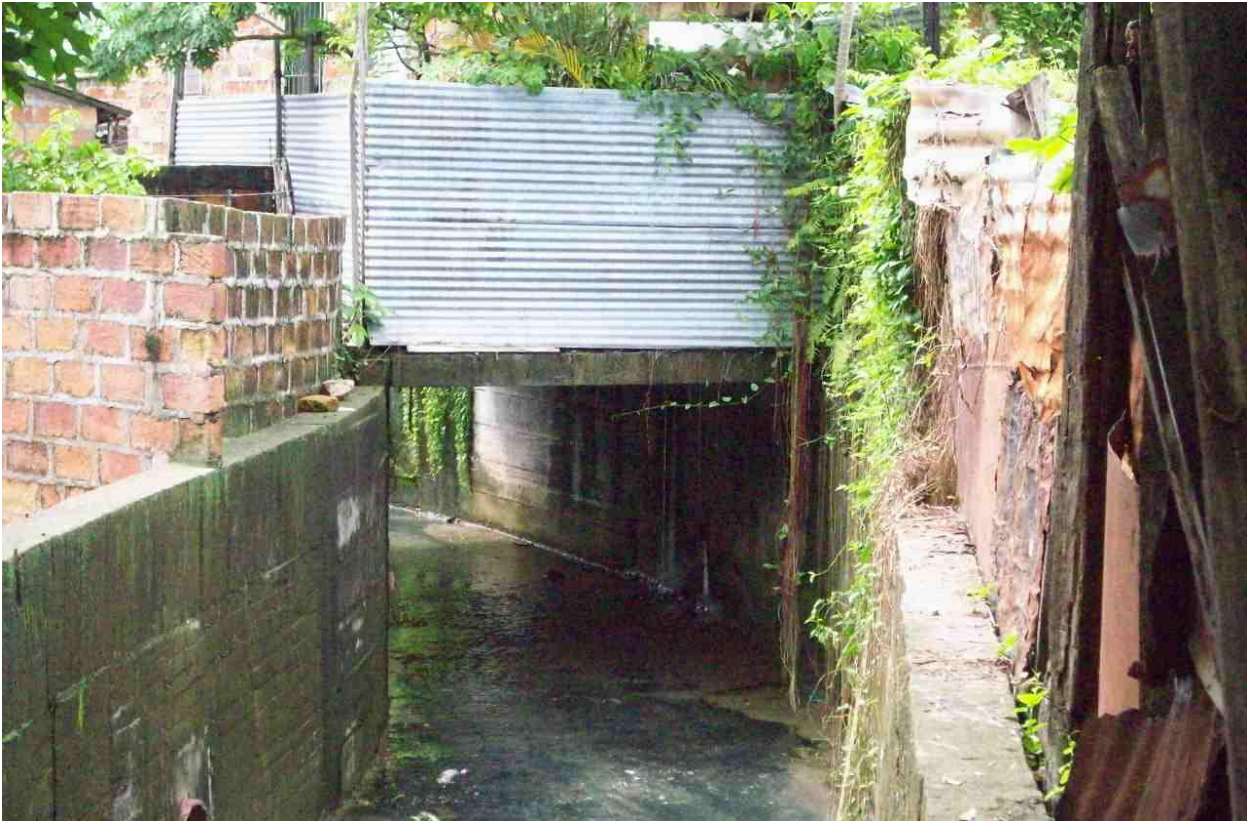
Foto No 6. Invasión de la Ronda Hidráulica, Ramal Primero de Mayo del Caño Las Camelias, Barrio Provivienda en el Municipio de Barrancabermeja
