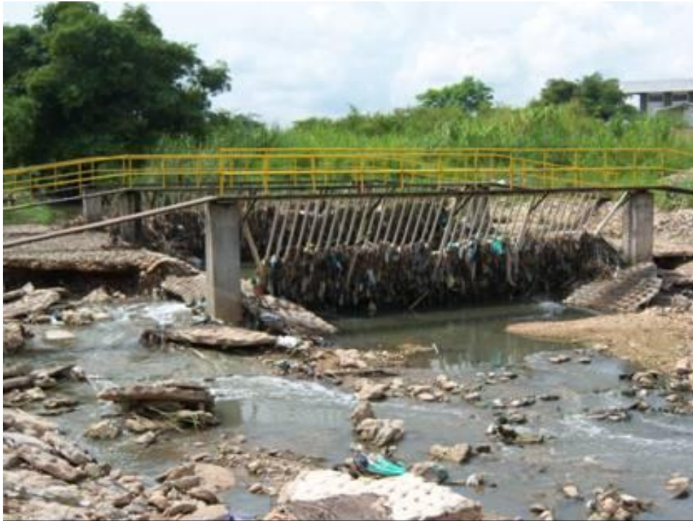
Foto No 9. Sistema de Cribado Caño Las Camelias, Sector Carrera 24 entre la avenida circunvalar y la avenida 25 de agosto en el Municipio de Barrancabermeja
