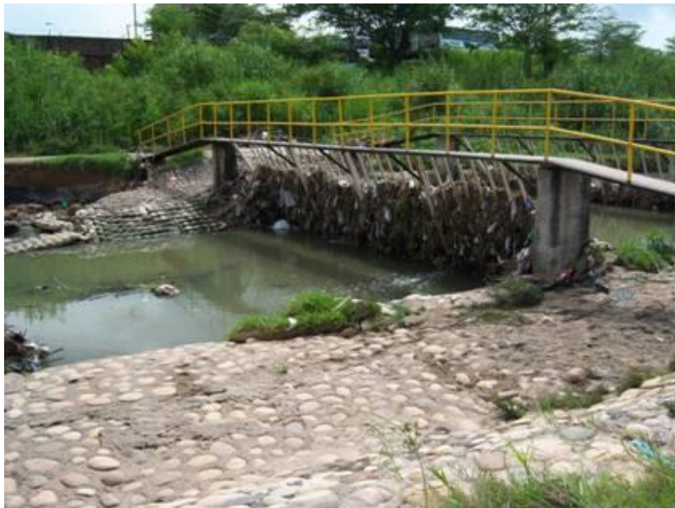
Foto No 10. Sistema de Cribado Caño Las Camelias, Sector Carrera 24 entre la avenida circunvalar y la avenida 25 de agosto en el Municipio de
