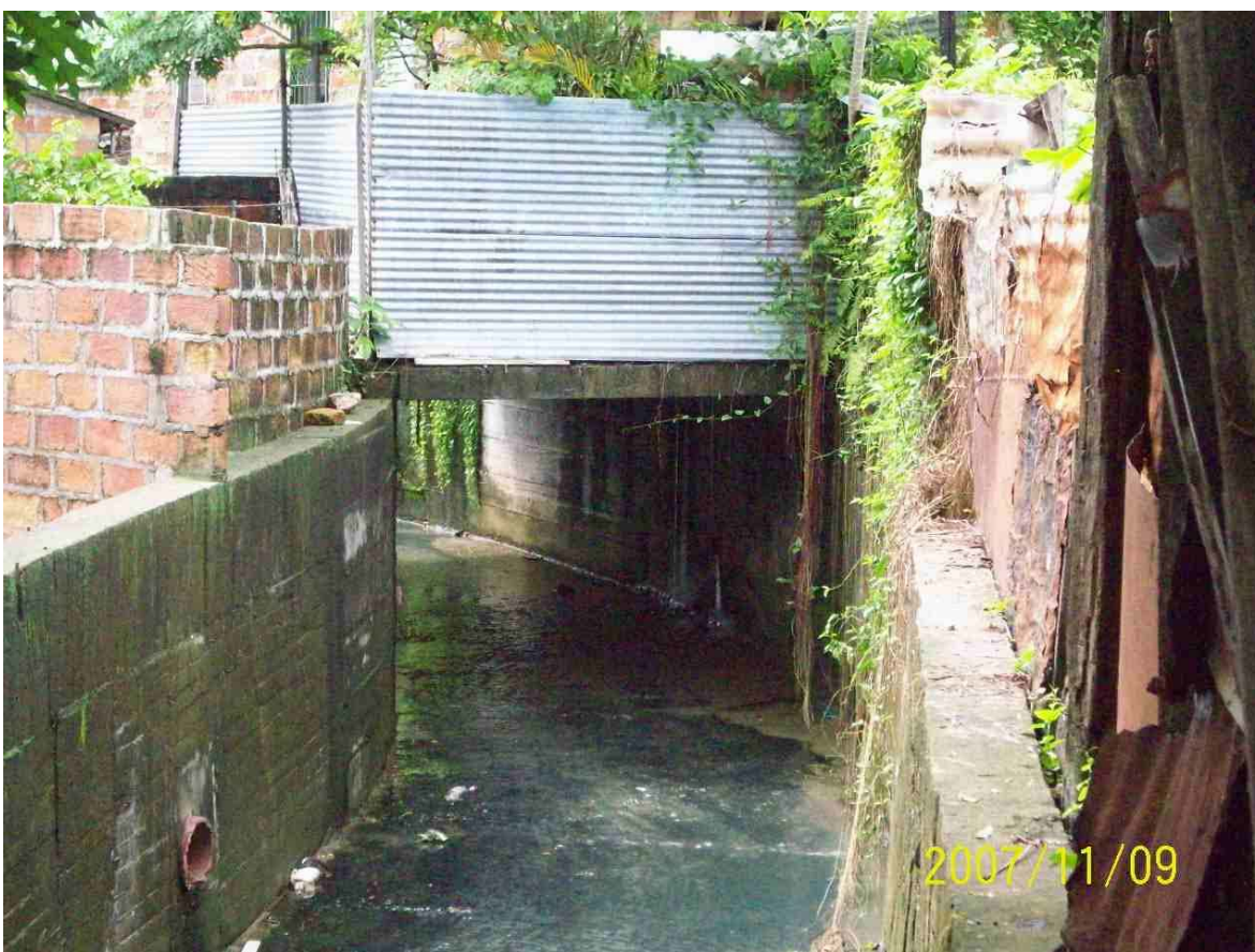
Foto N° 13. Invasión de la Ronda Hidráulica, Ramal Primero de Mayo del Caño Las Camelias, Barrio Provienda
