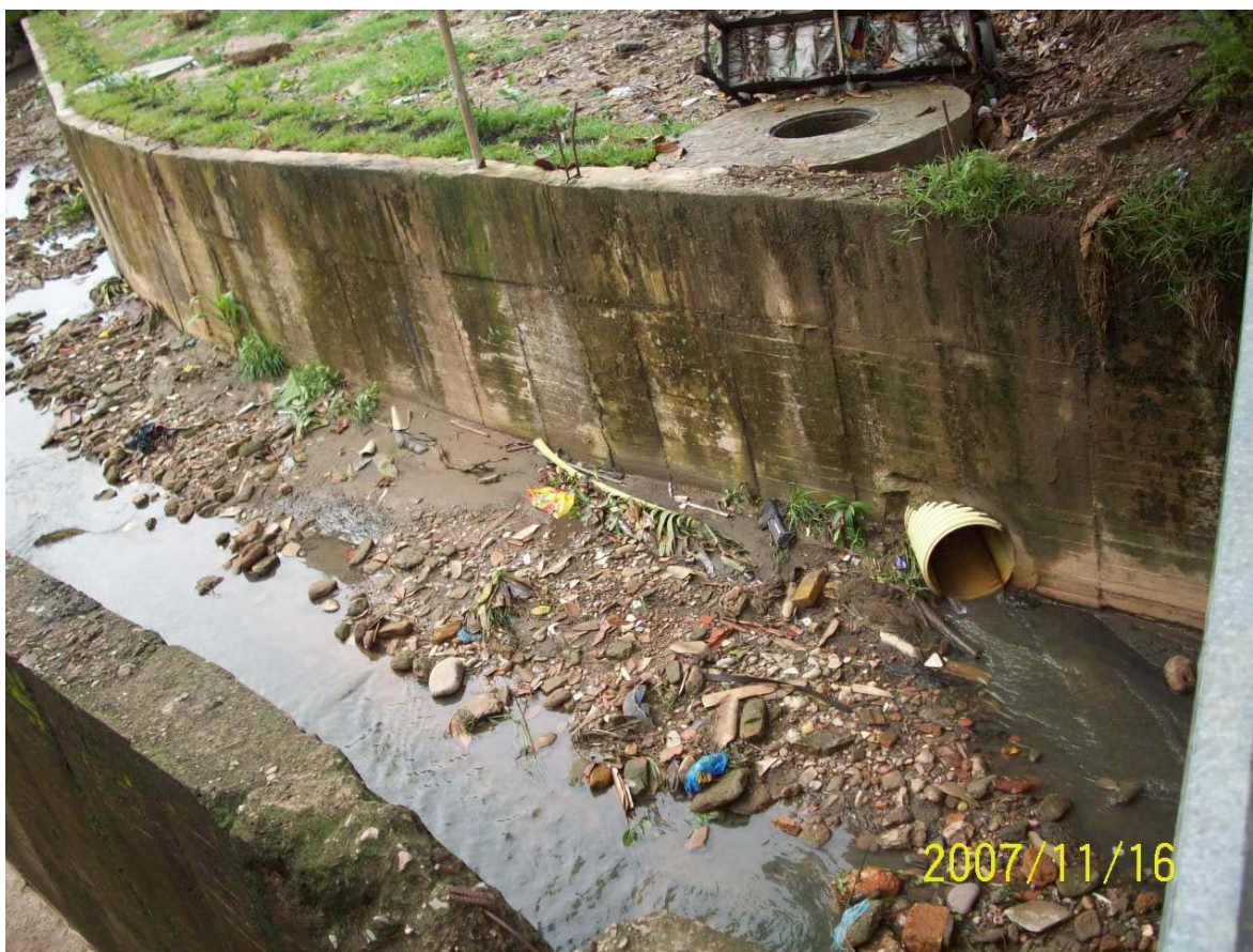
Foto N° 14. Vertimiento de Aguas Residuales, Ramal Principal del Caño Las Camelias, Barrio Las Camelias
