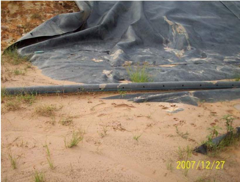
Foto N° 20. Tubería de conducción de Lixiviados de la Celda Transitoria
