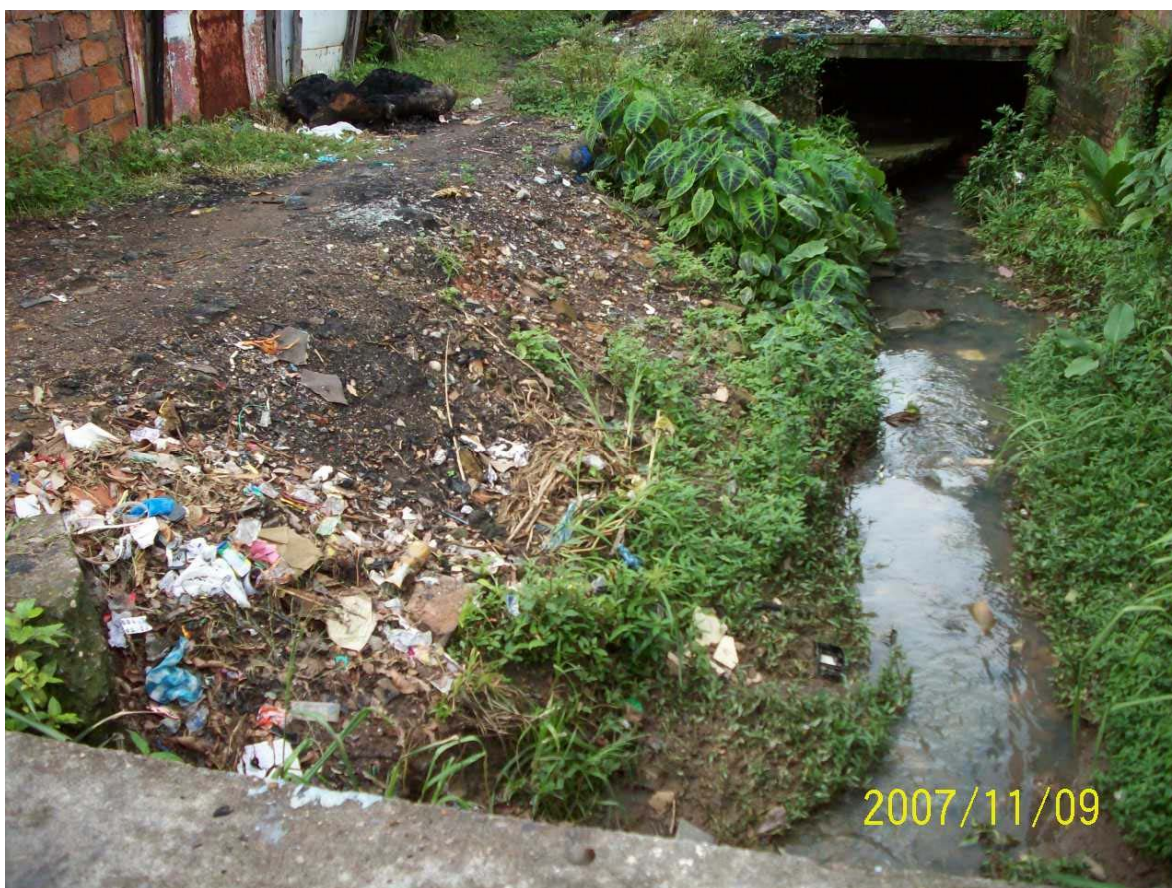
Foto N° 15. Disposición Inadecuada de Residuos Sólidos, Sector Ramal Primero de Mayo del Caño Las Camelias, Barrio Versalles
