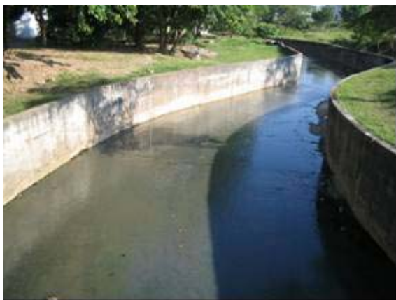
Foto N° 8. Canalización Vertical Caño Las Camelias
