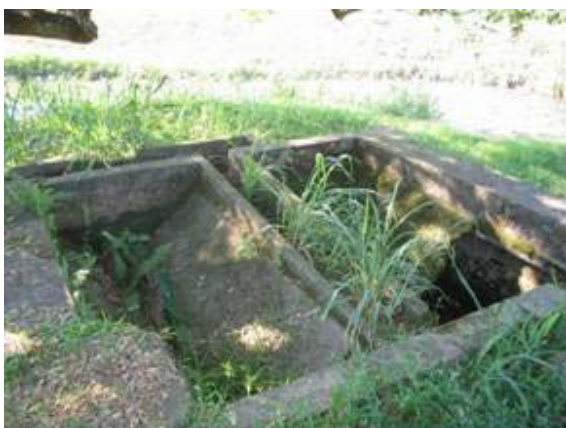
Foto N° 12. PTAR Barrio Villa Luz Fuera de Servicio
