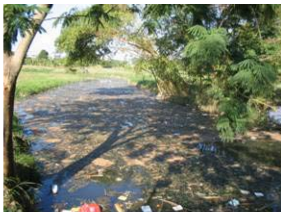
Foto N° 7. Efectos por la carencia del Sistema de Rejillas
