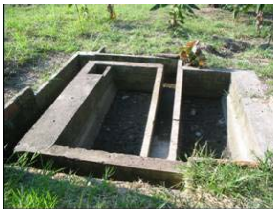
Foto N° 13. PTAR El flujo sale sin tratamiento
