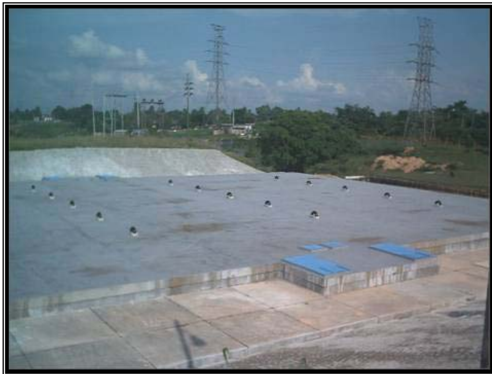
Foto N° 2. Tanque de Almacenamiento de Agua. Edasaba
